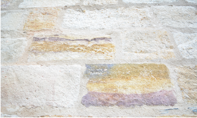
Fig. 4: Oxidación de la pudinga zamorana. Fuente: Autor del trabajo.
